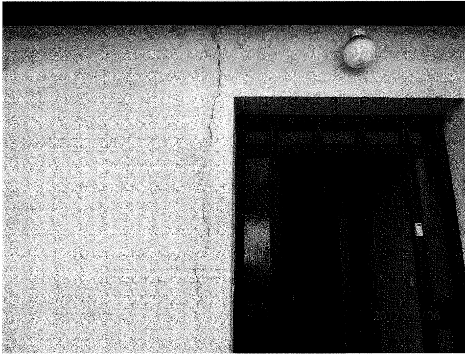
svislá trhlina administrativní budovy
